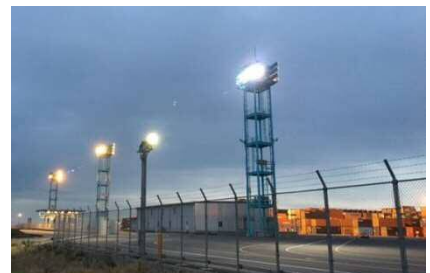
横浜港の屋外 LED 照明施設
